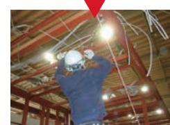
電気配線（ユニット部）
